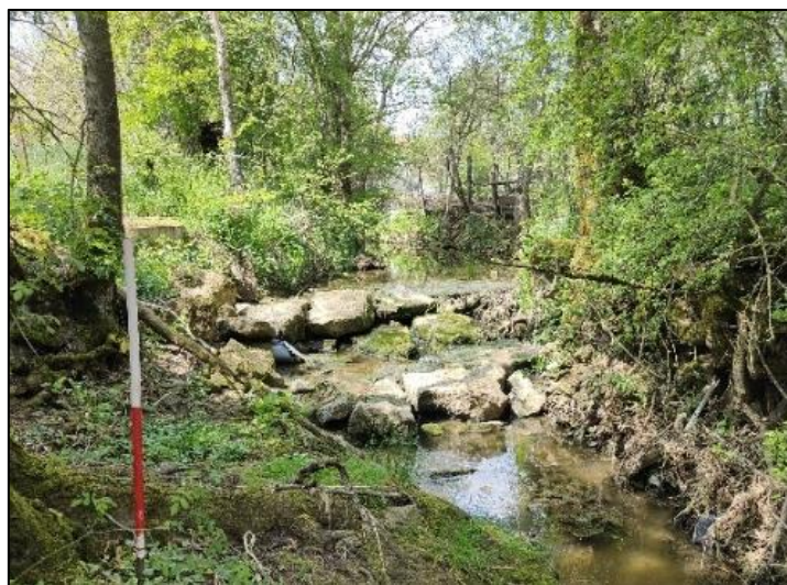
Figure 1 : Seuil à la sortie de Diarville
